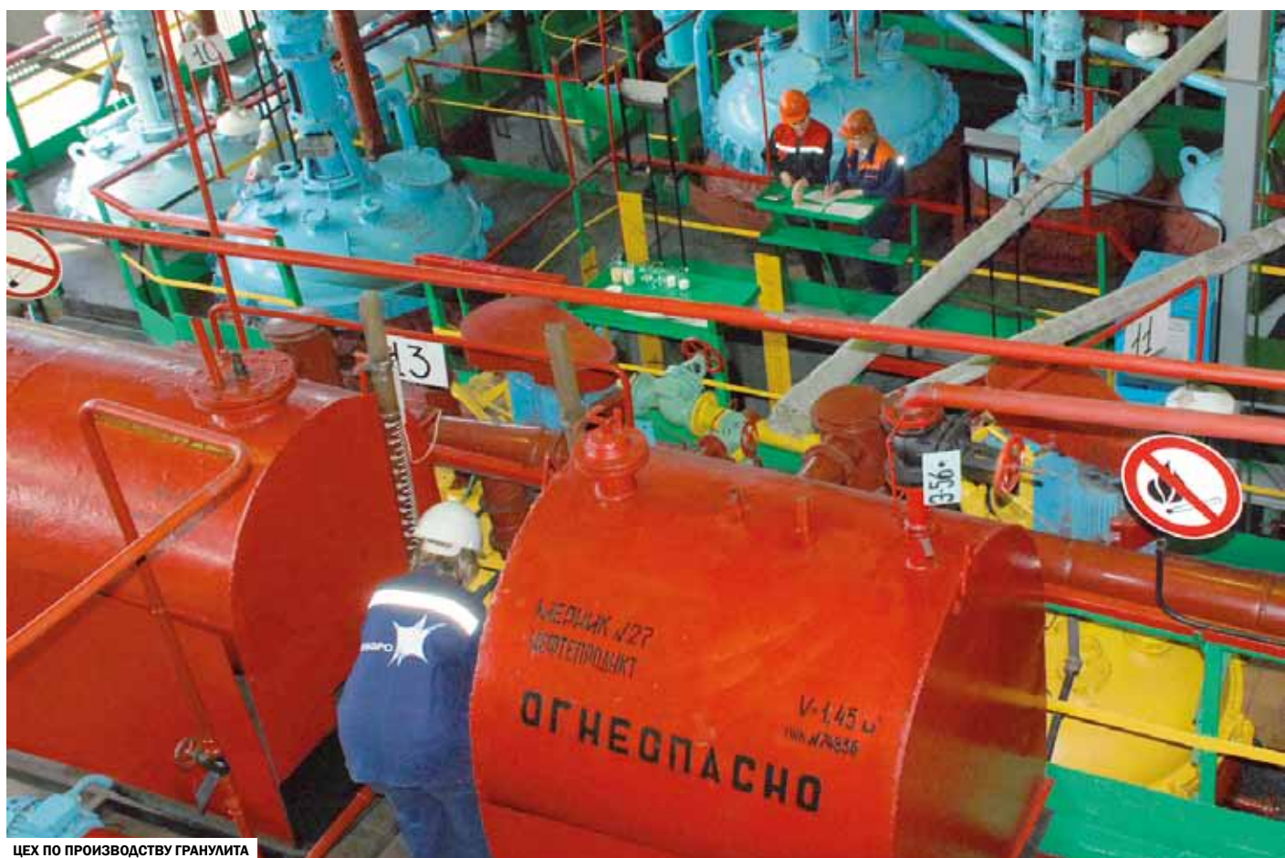
ЦЕХ ПО ПРОИЗВОДСТВУ ГРАНУЛИТА
